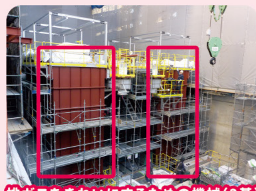
排ガスをきれいにするための機械(2基)
