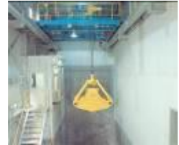
灰ピット・灰クレーン
